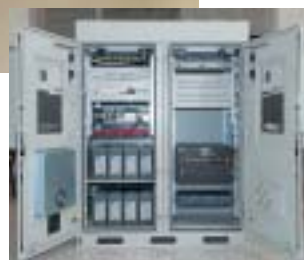
Новое оборудование – «всепогодный» шкаф для размещения аппаратуры телекоммуникаций
